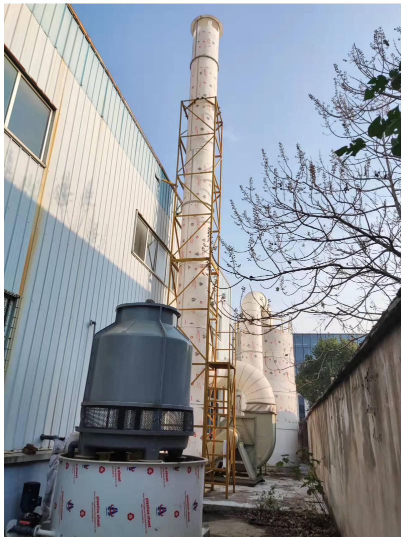
酸雾收集处理设施
