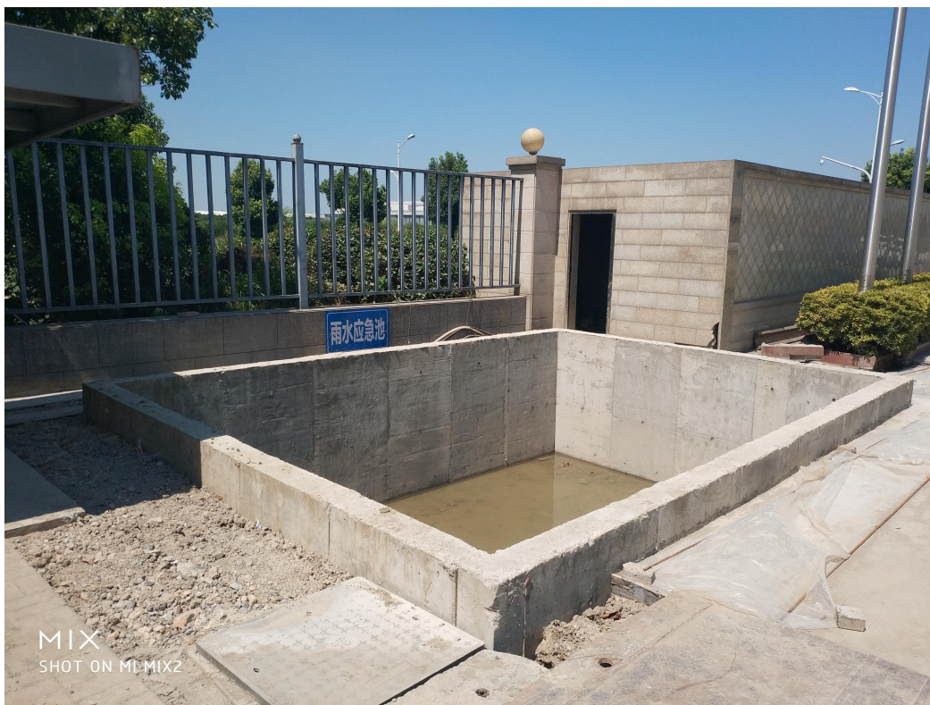
图 3-3 本项目雨水应急池现场图
